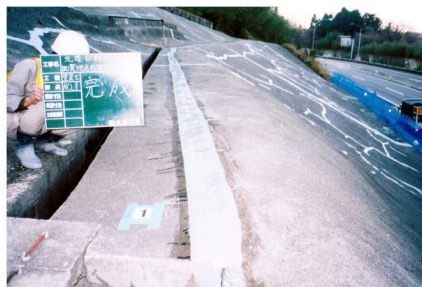
法面ひび割れ
