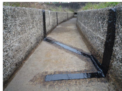
現場打ち水路 ひび割れ
